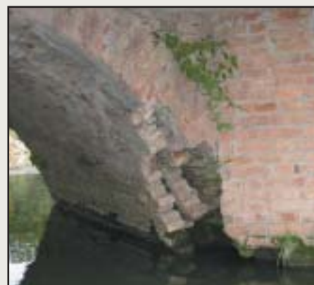
I danni al ponte sul Lusore
