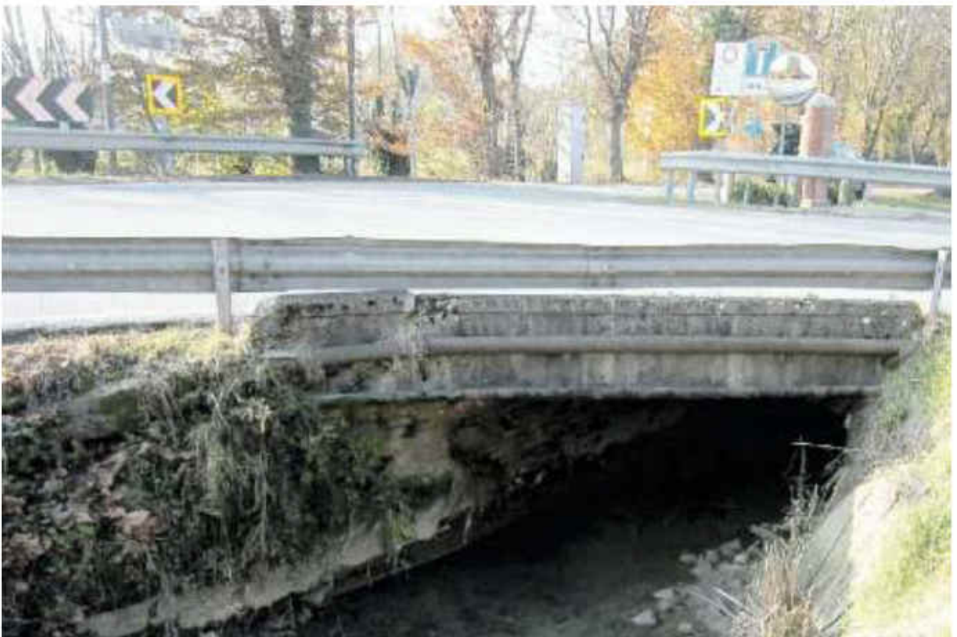
LAVORI Il ponte di via Scortegara, assai usurato. In alto vigili in azione in via Varotara a Zianigo.
